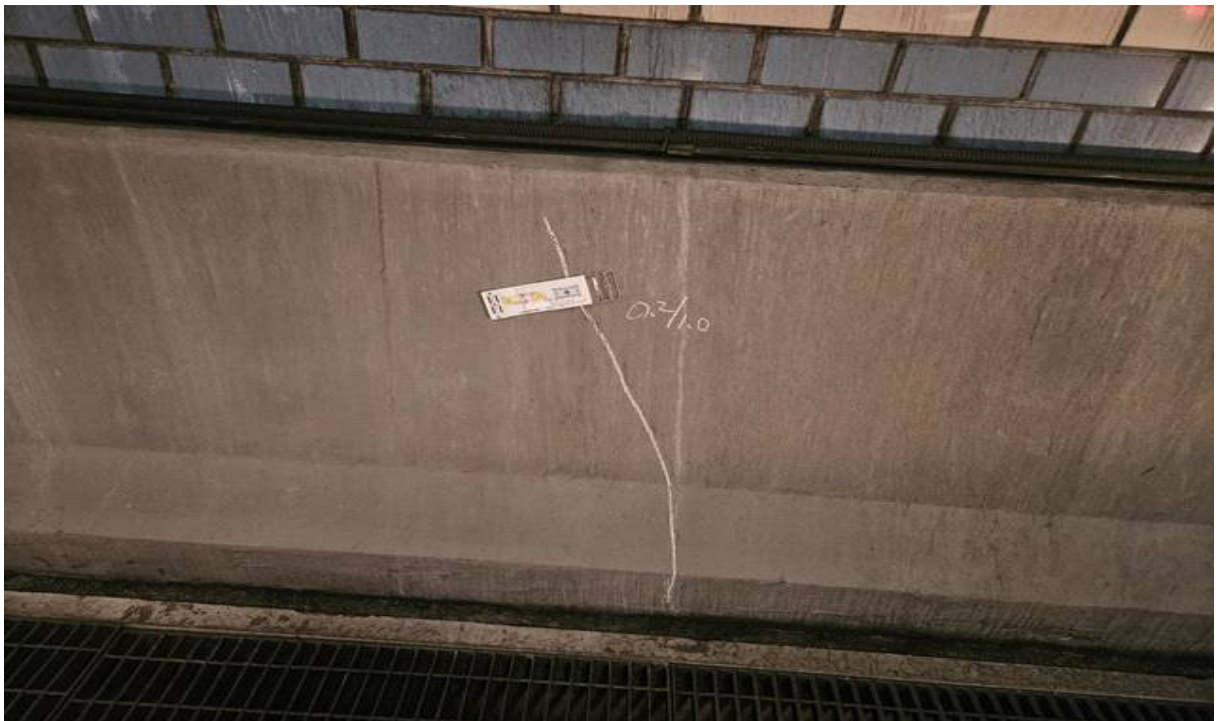
방호벽 S1 균열(Cw=0.2mm)
