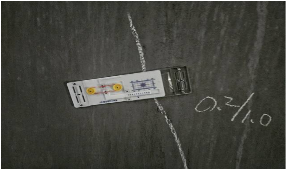
방호벽 S1 균열(Cw=0.2mm)
