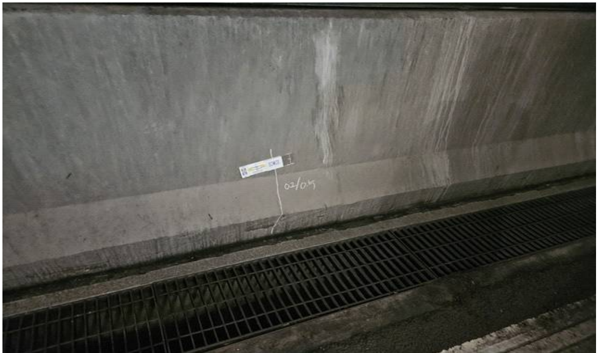
방호벽 S1 균열(Cw=0.2mm)
