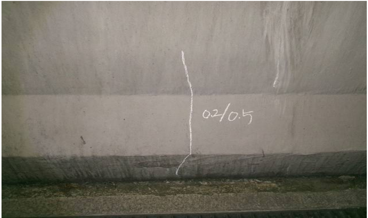
방호벽 S1 균열(Cw=0.2mm)
