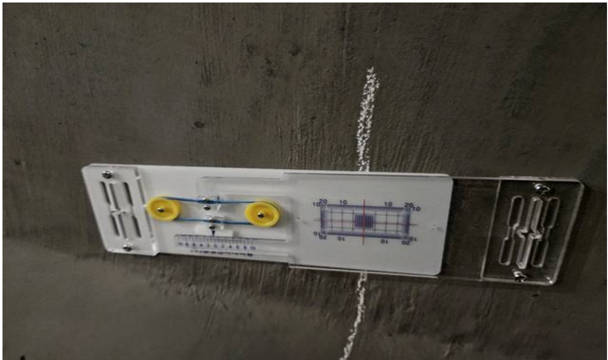
방호벽 S1 균열( C_w=0.2\text{mm} )
