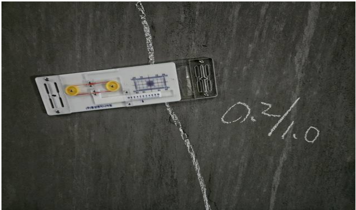
방호벽 S1 균열(Cw=0.2mm)
