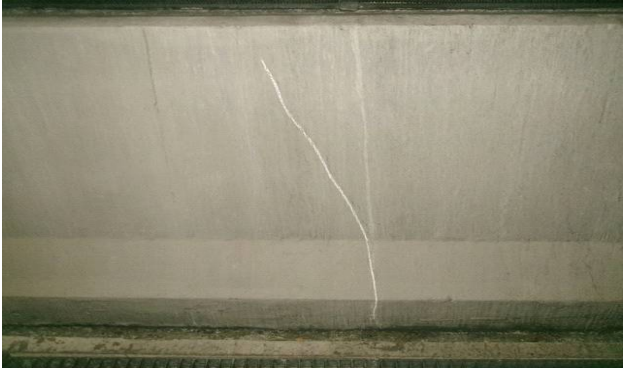
방호벽 S1 균열(Cw=0.2mm)
